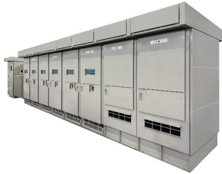
パワーコンディショナー(PCS):明電舎
